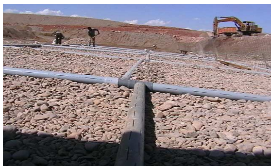
شکل ۲- شبکه زهکشی زیر حوضچه آرامش سد انحرافی تبریز.
