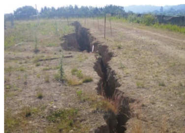
(الف) وقوع ترک کششی در پشت دیوار خاک مسلح [۱]
