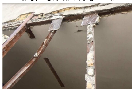
(ه) کماتش جانبی مهاربند به دلیل عدم کفایت مقطع
