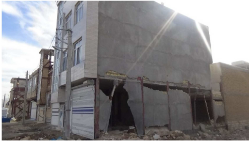
شکل ۵- ساختمان سه طبقه آسیب دیده در زلزله سرپل ذهاب با سیستم مهاربند برون‌محور
