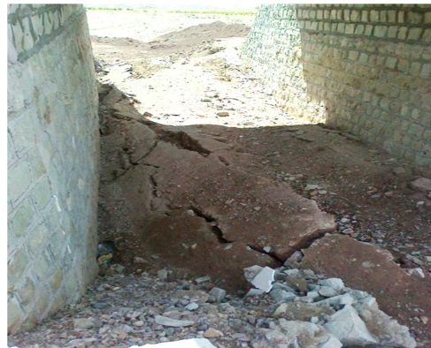
شکل ۴- انتهای زمین لغزش روشک در فاصله بین دو پایه پل
