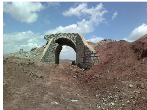
شکل ۵- تخریب پل سنگی در اثر لغزش زمین روشک
